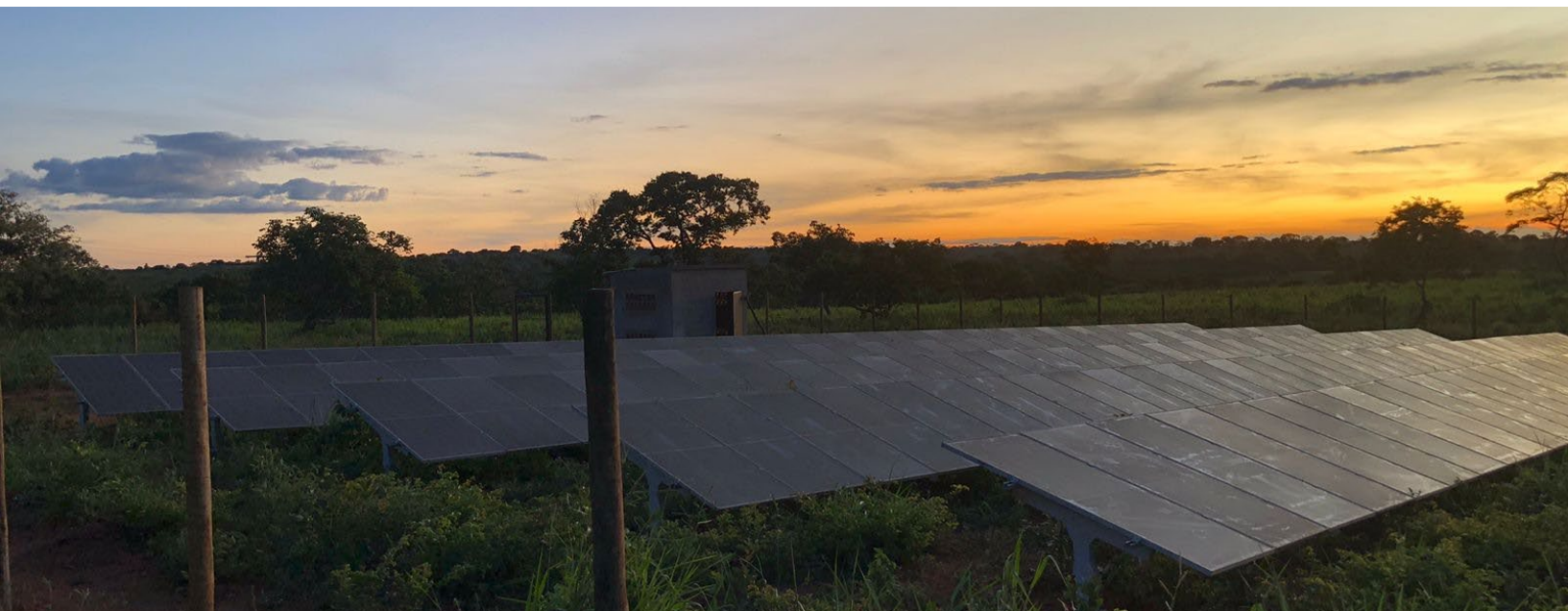
Placas em funcionamento em Mirabela (MG)
